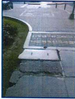
DESPRENDIMIENTO DE SUPERFICIE DE CONCRETO EN VEREDA
